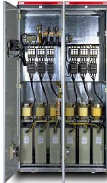
Автоматическая конденсаторная установка с защитными реакторами
